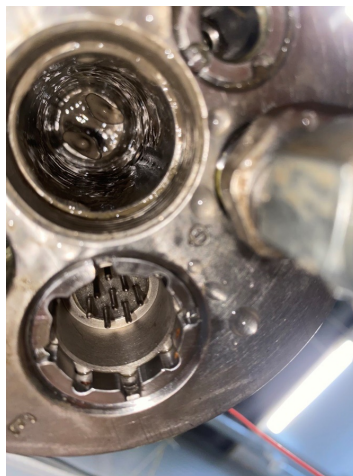
Рисунок 11. Состояние измерительной камеры после проливки водой с температурой 60 °С
